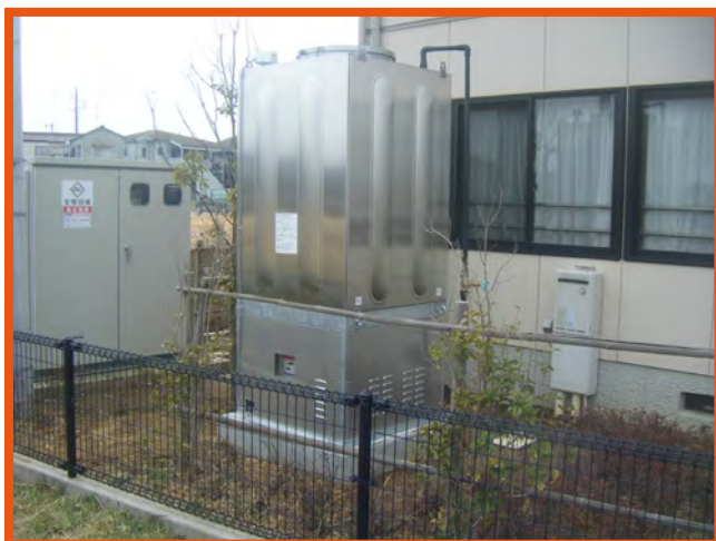
スプリンクラーポンプユニット設置状況
