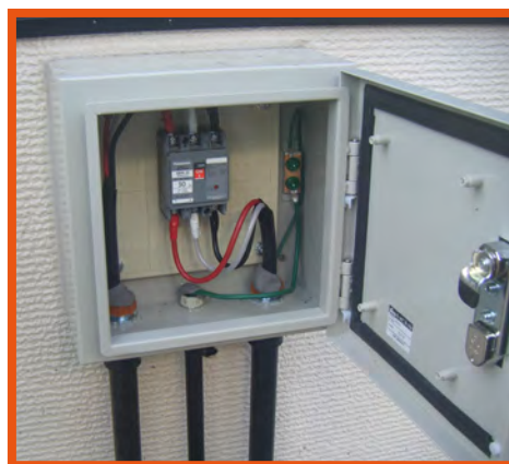
スプリンクラーポンプ専用ブレーカー
