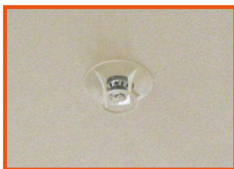
スプリンクラーヘッド設置状況
