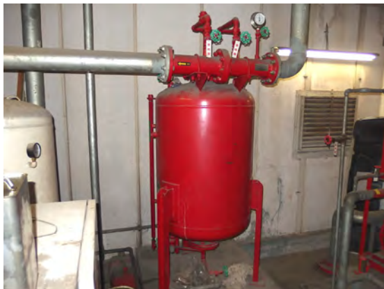
P-FOS 含有泡消火薬剤抜取り前
