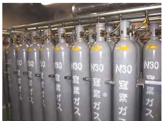
N2 ガス容器更新完了
